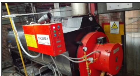
FOTOGRAFÍA N.º 5. CALDERA DE 60 BHP
